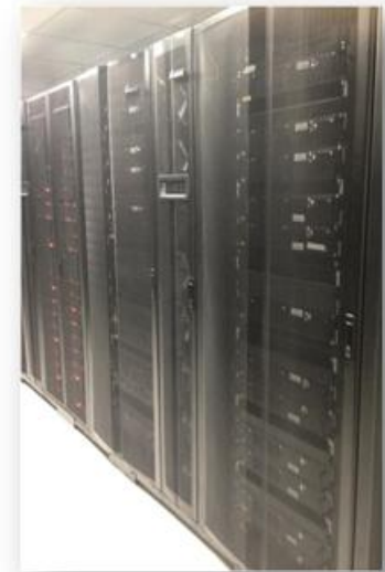
高密度區 >5KW/Rack
