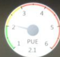
陽光大樓機房當天PUE統計
